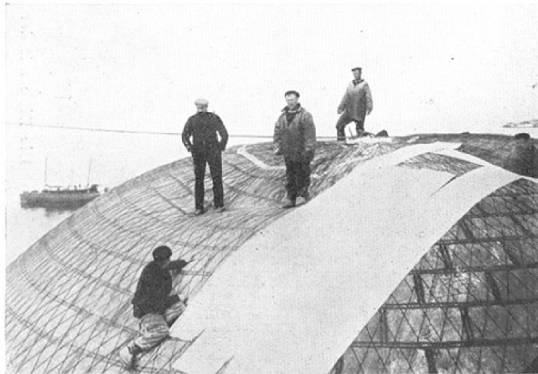
Phot. Svedenborg Auflegen der mit Bleiessig getränkten Zeugstreifen, um undichte Stellen zu finden
